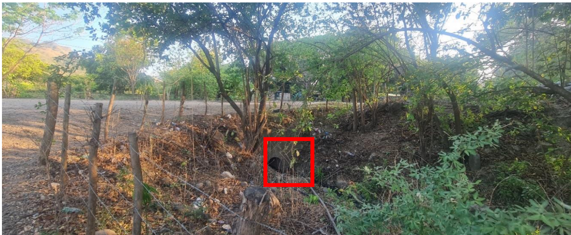
Figura 32: descarga de rastra por desagüe subterráneo (indicado en recuadro rojo).
