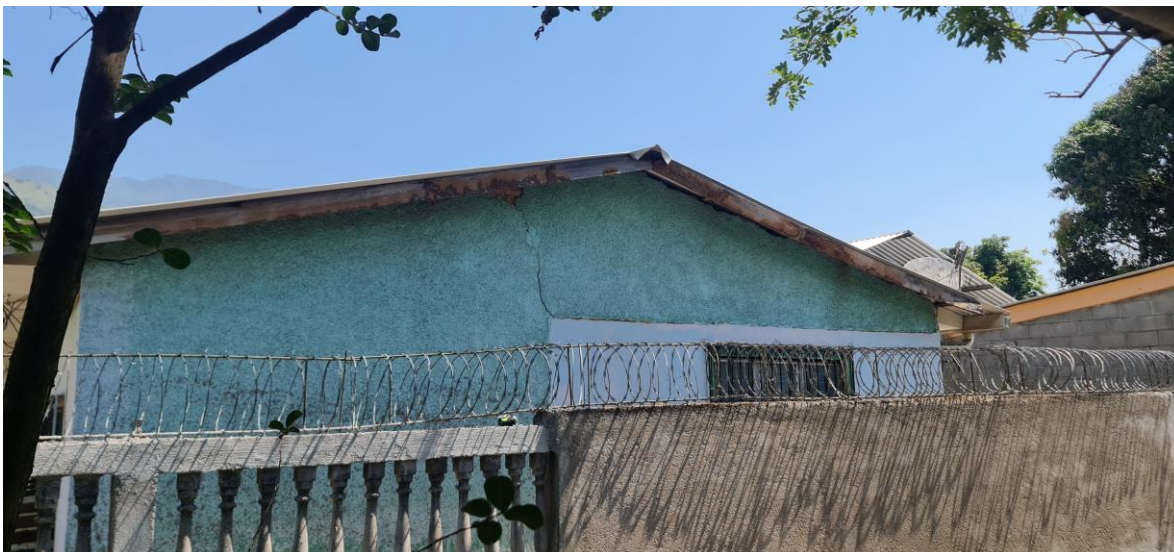
Ilustración 7 Escuela de la comunidad de Yaruca con afectaciones por la falta de presencia institucional
